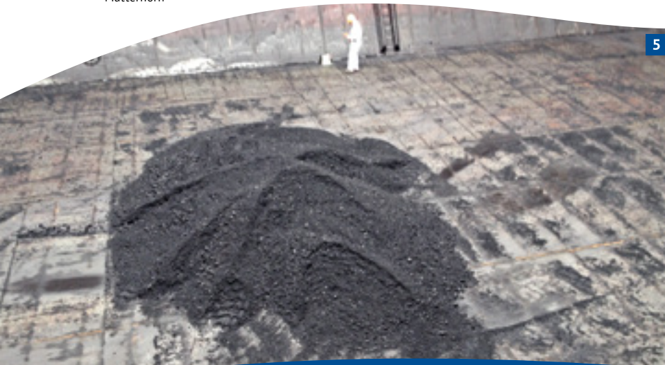
5 - 7 Zustand des Laderaumbodens nach 18-monatiger Nutzung auf der „Berge Matterhorn“
