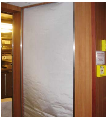
Brandschutz-Vorhang (A-0) in eingebautem Zustand
