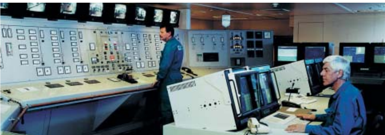
Maschinenkontrollraum eines Kreuzfahrtschiffes zur Überwachung des Schiffsbetriebes
