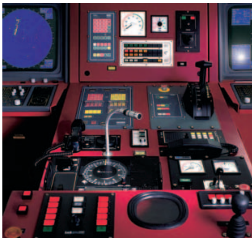
Moderne Steuer- und Überwachungsanlage auf einer Kommandobrücke
